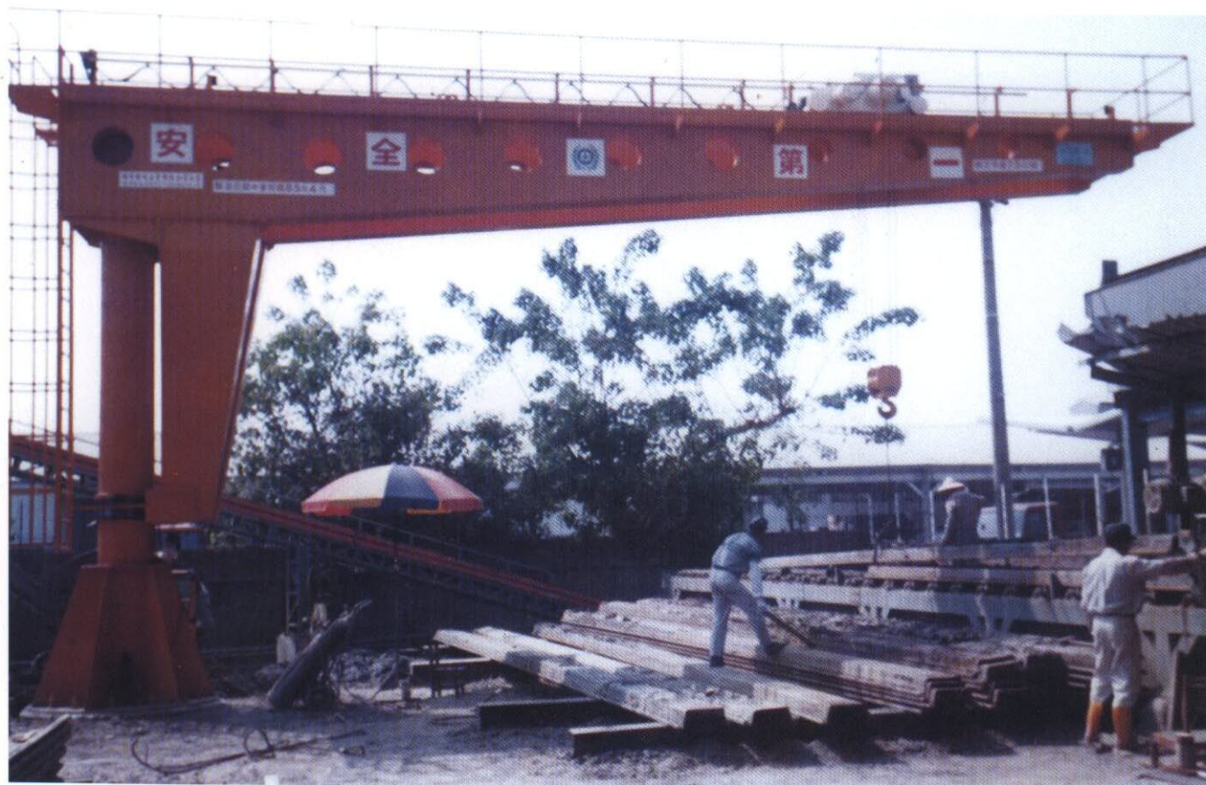
伸臂式起重機 (JIB CRANE) 中鹿營造仁武廠實攝 (7.5T×12M)
