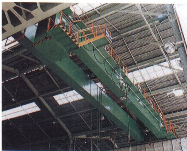
OVERHEAD CRANE 架空式起重機
